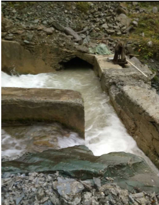
万家沟取水枢纽
