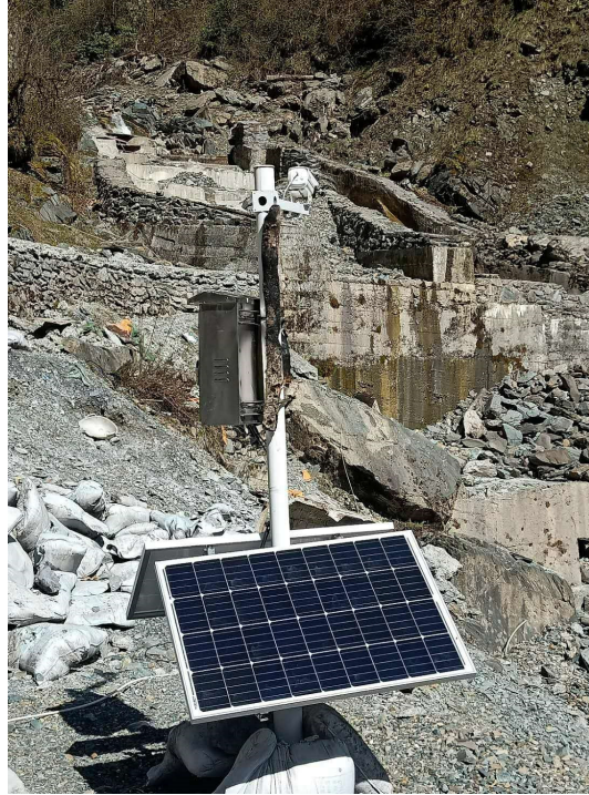
包家沟取水枢纽生态流量下泄监控设施
