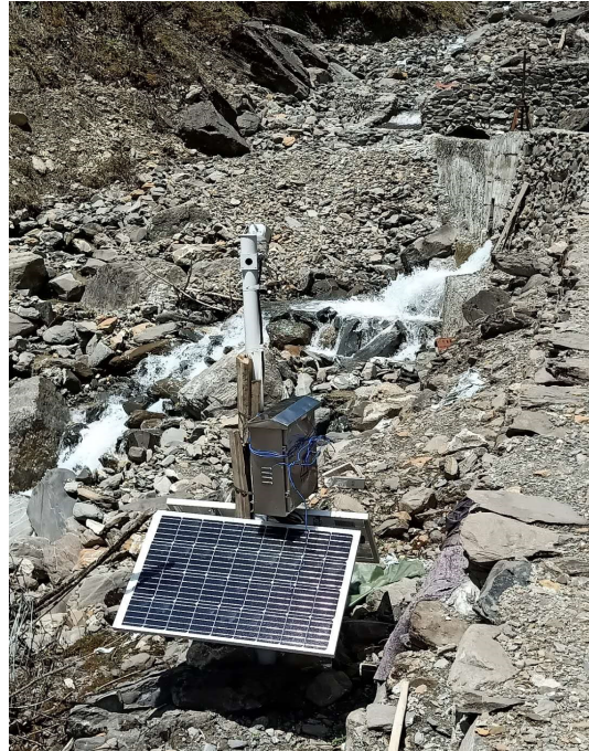
万家沟取水枢纽生态流量下泄监控设施
