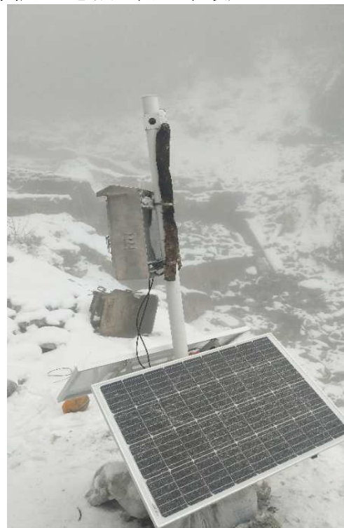
阮家沟取水枢纽生态流量下泄监控设施
