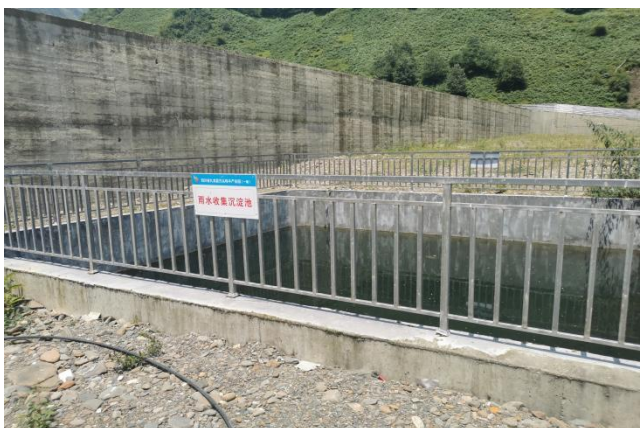
雨水池（接雨水管网）
