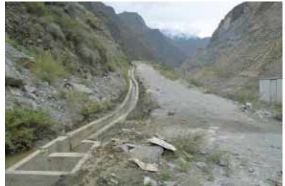
道路排水设施
