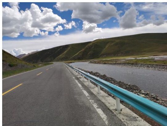
路基临河侧 波形防撞护栏
