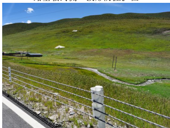
路基临河侧 钢索防撞护栏
