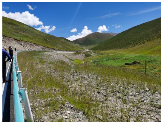
路基临河侧 波形防撞护栏
