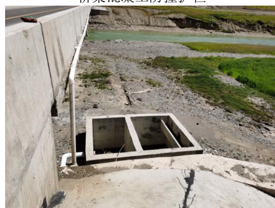
雅砻江大桥 桥面径流收集系统
