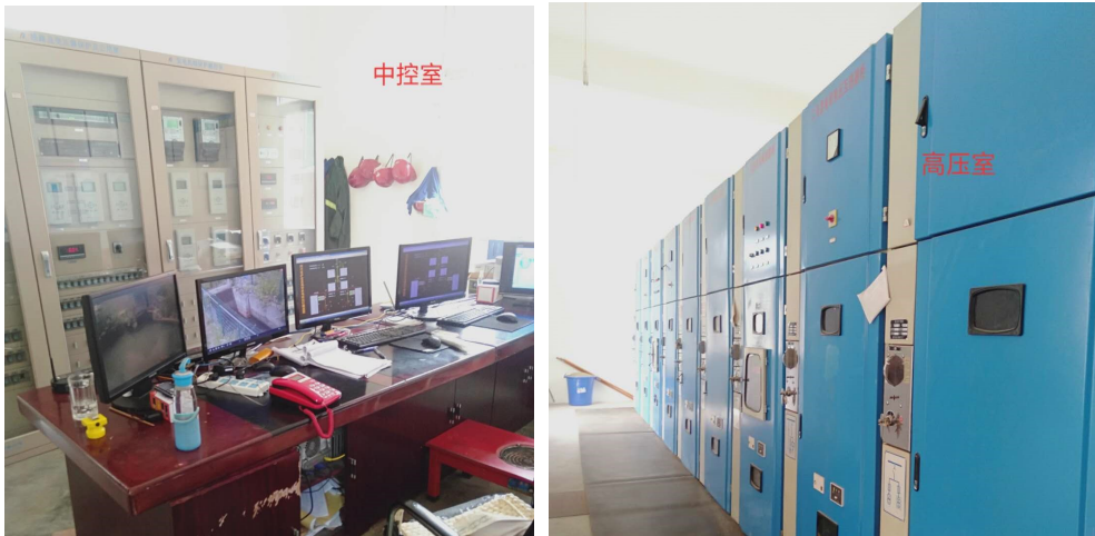
电站中控室和变压器室
