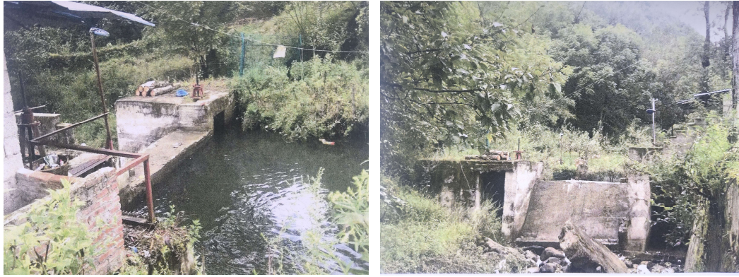
取水枢纽及生态流量监控设施
