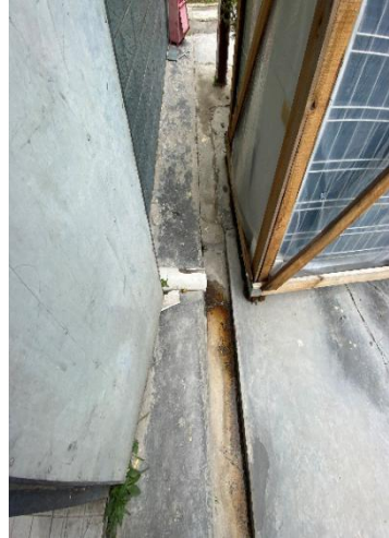
b. 乡政府周围屋排水沟情况
